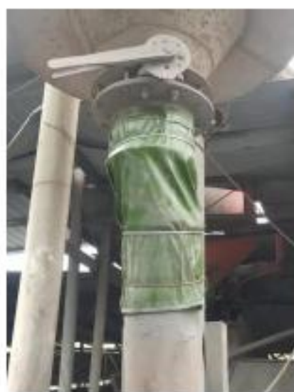
粉煤灰储罐防漏
