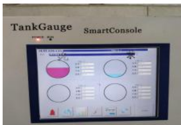
储油罐液位管理系统
