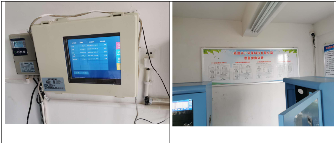
图 4-2 在线监测系统现场照片
